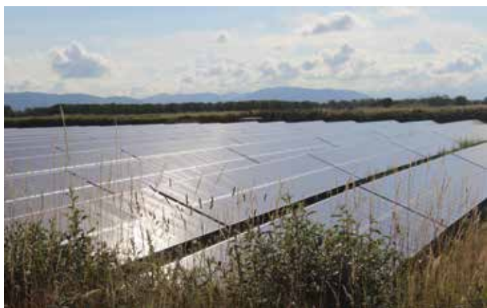
Parc solaire de Grenoble Air Parc, à Saint-Étienne de Saint-Geoirs.
